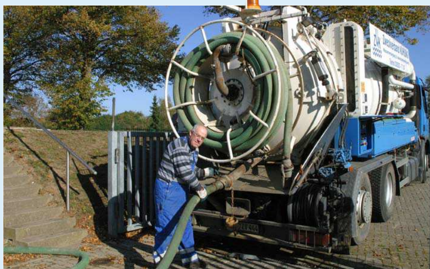
Ernst-Hartmut Grzeskowiak pumpt den Schlamm aus Kleinkläranlagen per Saugwagen ab und fährt ihn zur zentralen Schlammbehandlung ins Doberaner Klärwerk.
