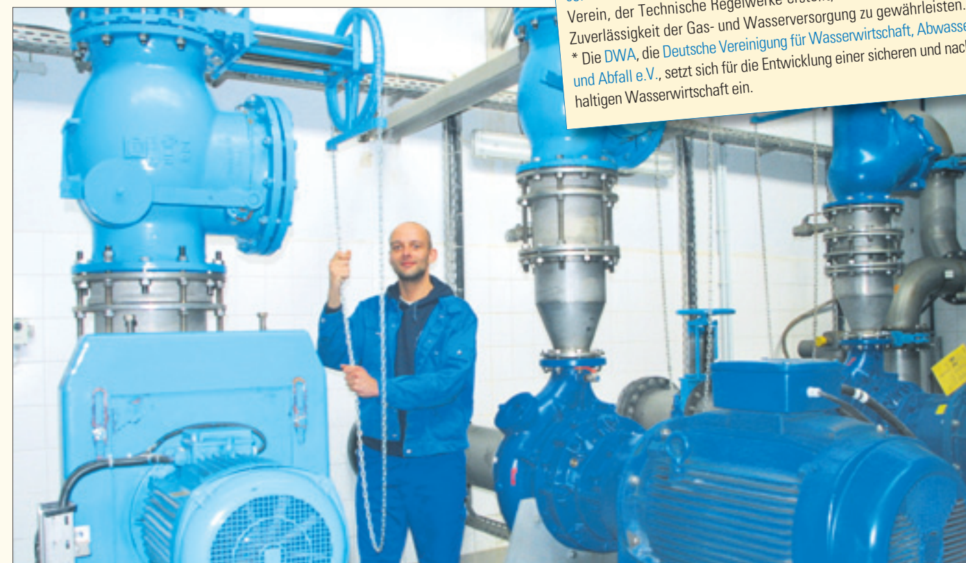
Nur mit ausgezeichneten Anlagen und gut ausgebildeten Mitarbeitern, hier im Bild Manuel Kuhn im Hauptpumpwerk in Kühlungsborn, hat man eine Chance auf das TSM-Gütesiegel.
