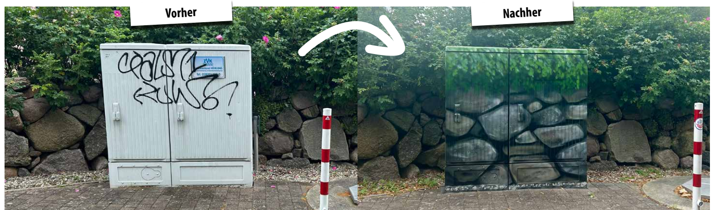
Unansehnlich der Schaltschrank vor seiner Umgestaltung.
